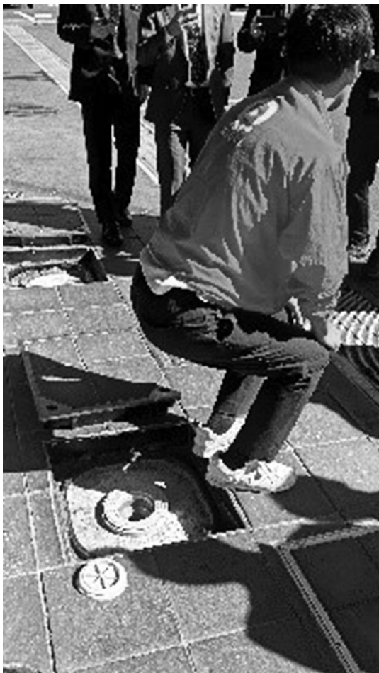
災害時のトイレ設置個所の排水口
